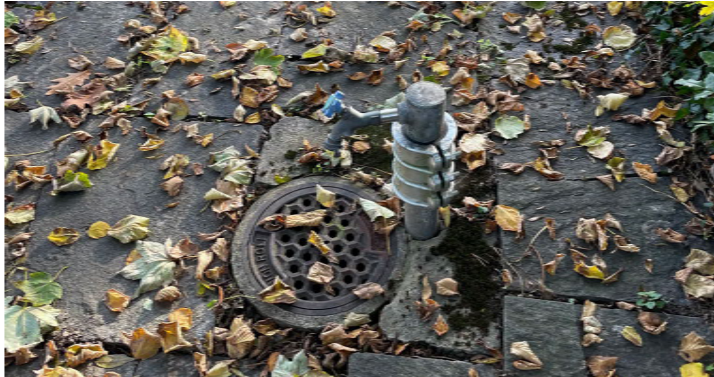
Marode Wasseranschlüsse -> Rückbau
