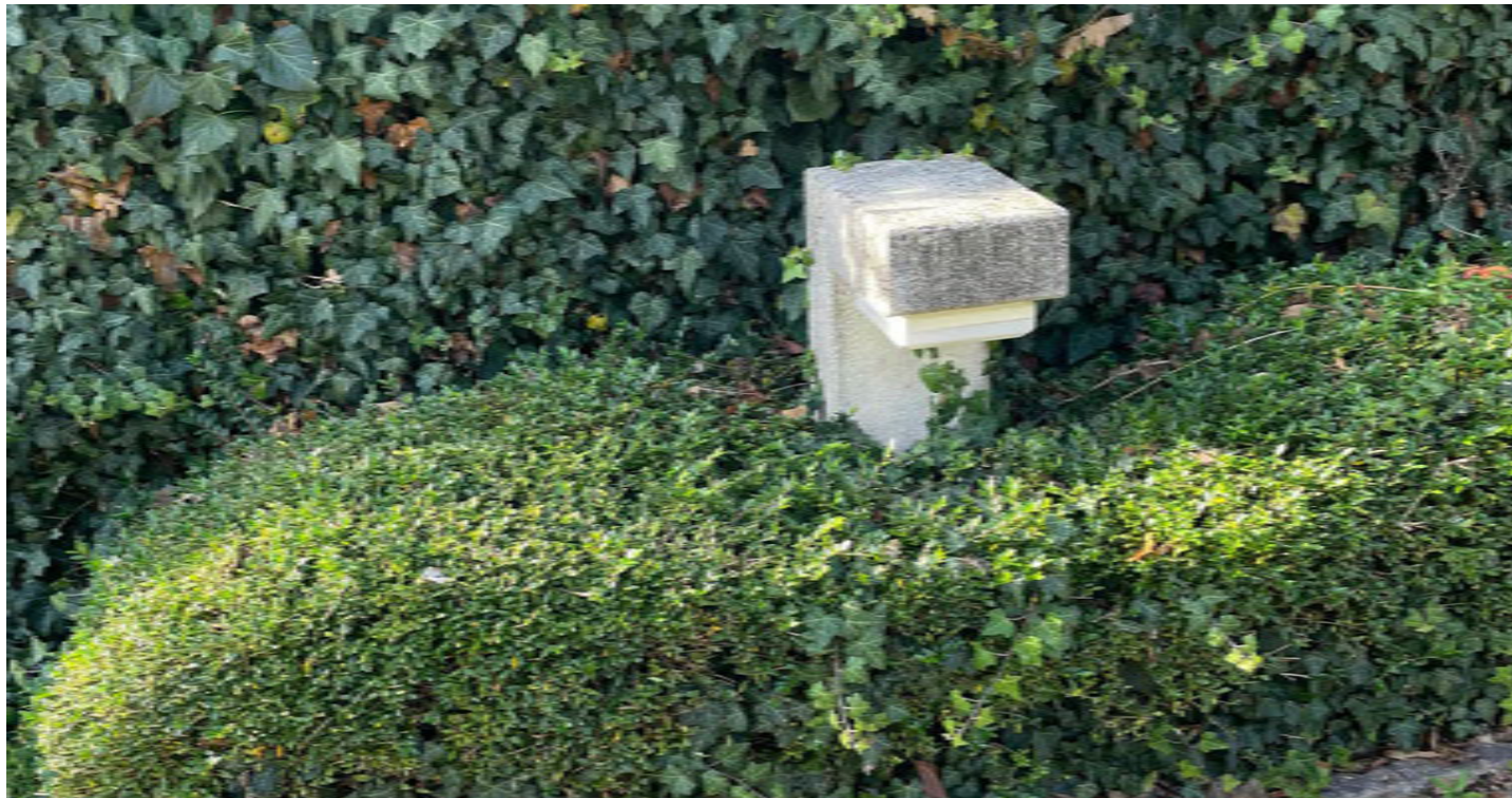
Pollerleuchten (allenfalls instandstellen)
